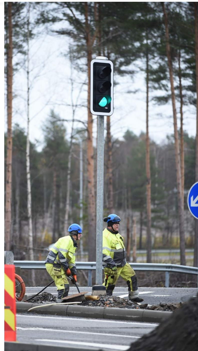
Kuva: Iskon eritasoliittymä, Oulu
